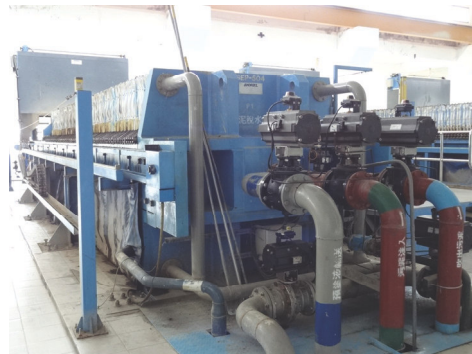
圖1-15 淨水場污泥脫水機
