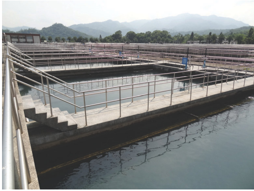
圖 1-3 淨水場快濾池
