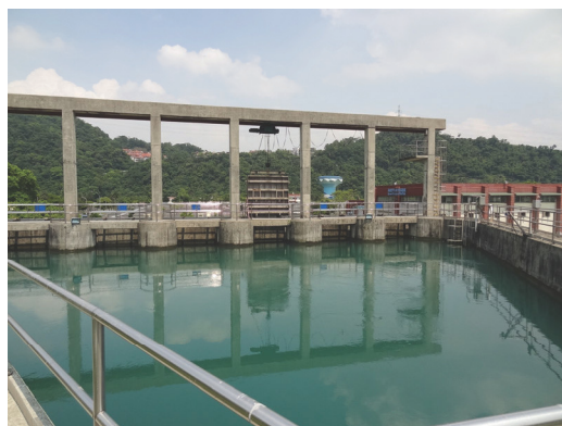
圖 1-9 淨水場分水井
