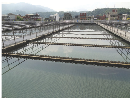
圖 1-12 傾斜管式沉澱設備
