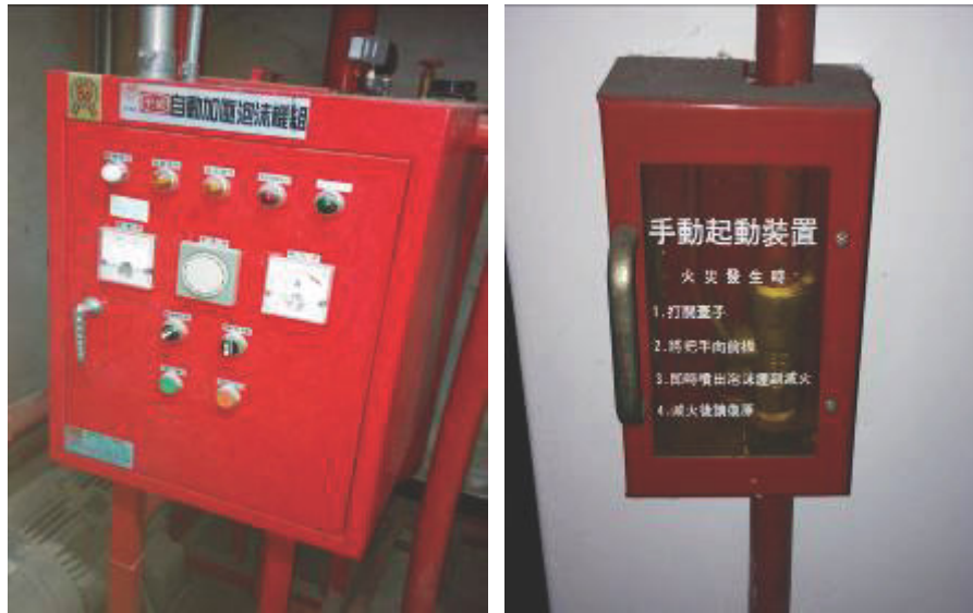
圖 5-13 消防泡沫滅火設備
