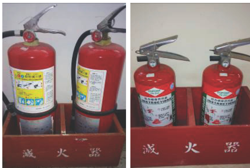
圖 5-14 消防乾粉滅火設備
