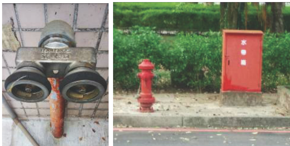
圖 5-12 室外消防栓(送水管、水帶箱)滅火設備
