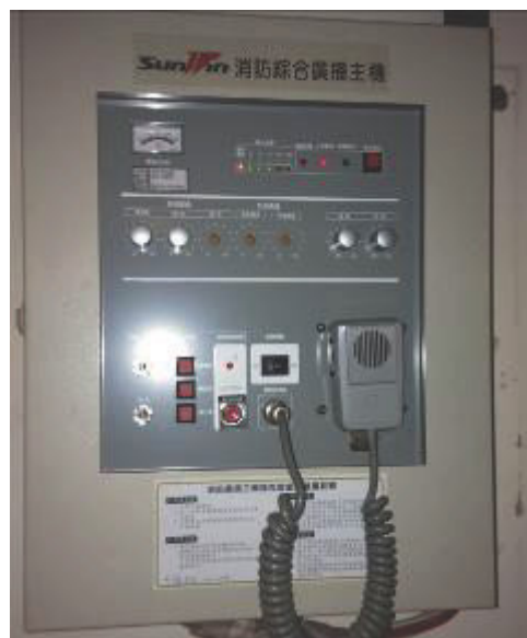
圖 5-16 消防廣播主機設備
