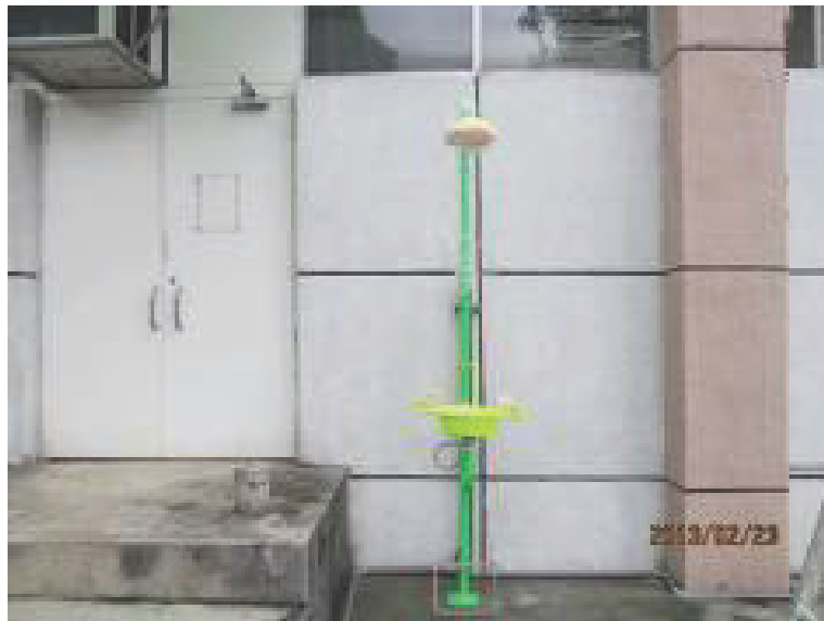
圖 5-6 緊急淋洗設備
