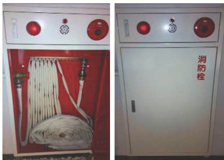
圖 5-11 室內消防栓滅火設備
