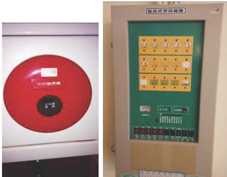
圖 5-15 火警發信機與受信總機設備
